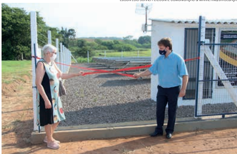
Duas usinas fotovoltaicas dão conta da produção de energia consumida
